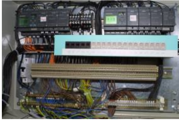
geosolár hőközpont vezérlő elektronikája Tervező, kivitelező: Lányi Tamás elektromérnök
